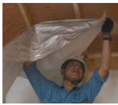
① 小屋裏（室内側）から、アルミ面を屋根（外側）に向けて施工します。
