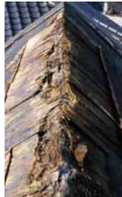
腐朽菌により老朽化した屋根
