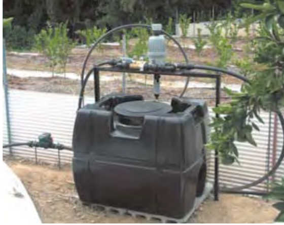
導水管、液肥タンク、液肥混入器、電磁弁一体型灌水制御装置
