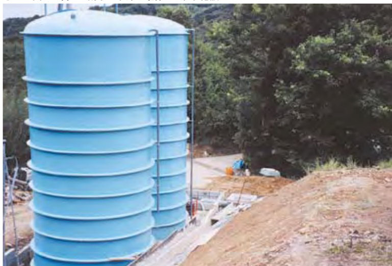
●上の園地に降った雨水で水源を確保した灌水施設
